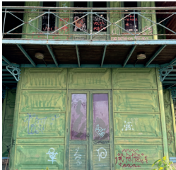
Figura 2 (acima) Danos no Chalé de Ferro. Fonte: Cibelly Figueiredo, 2024.
