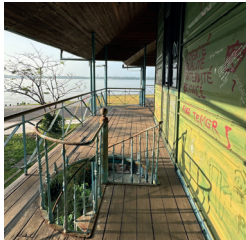
Figura 3 (acima) Danos no Chalé de Ferro. Fonte: Cibelly Figueiredo, 2024.
